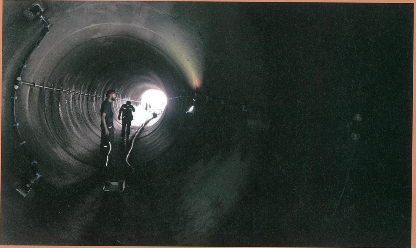
이탈리아 개수로에 자인테크놀로지(주) 유량계 센서가 설치된 현장의 모습
