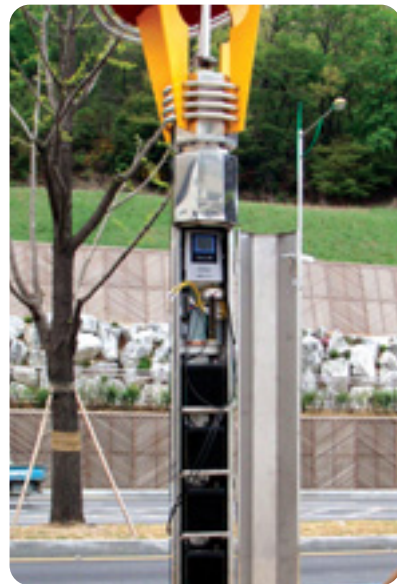
내장된 충전배터리 및 충전 컨트롤러
